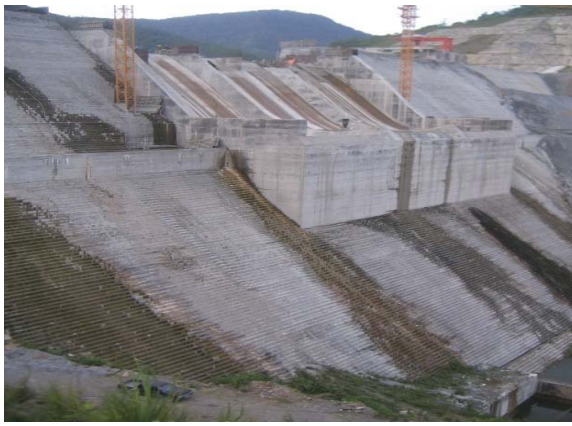
Hình 2: Hiện trạng thấm đập thủy điện Bản Vẽ
