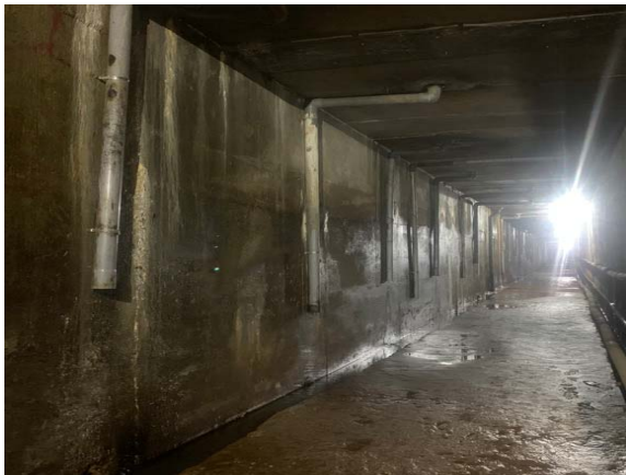
Hình 3: Hiện trạng thấm đập thủy điện Đồng Nai 5
