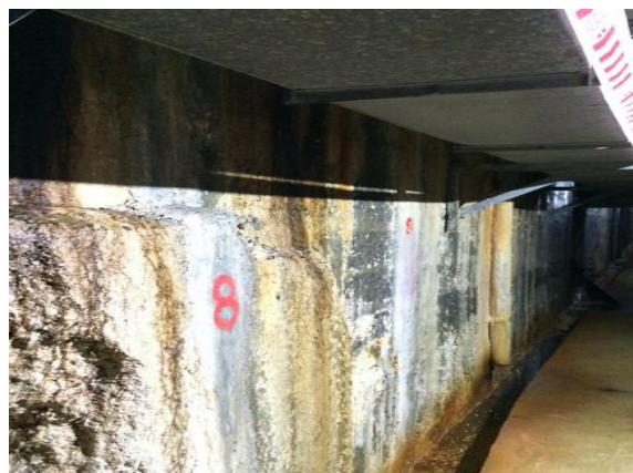
Hình 1: Hiện trạng thấm thủy điện Đồng Nai 3
