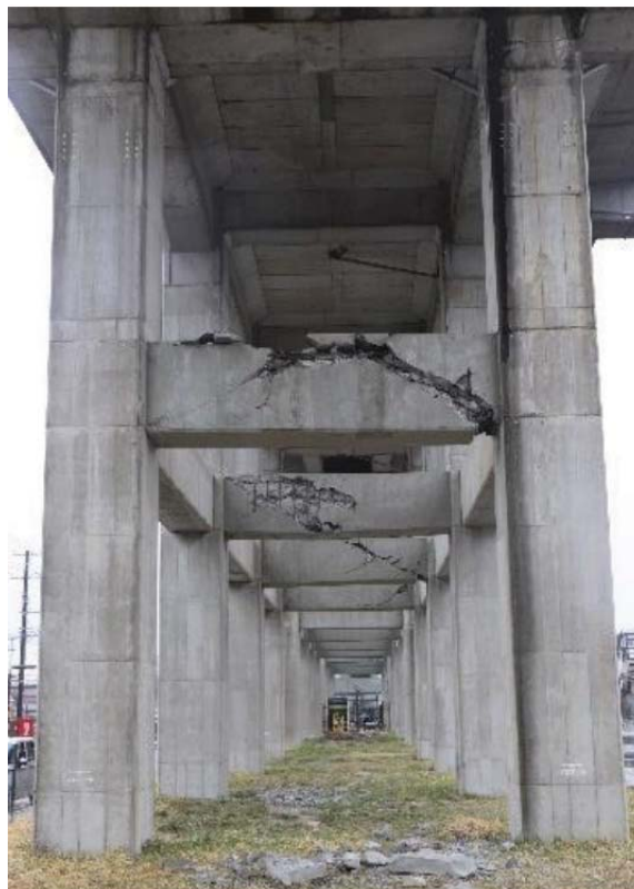
Hình 5: Hư hỏng khung cầu cạn
