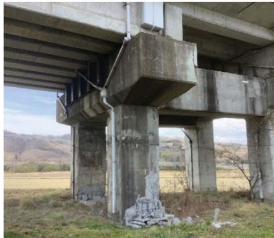
Hình 2: Hư hỏng trụ cầu
