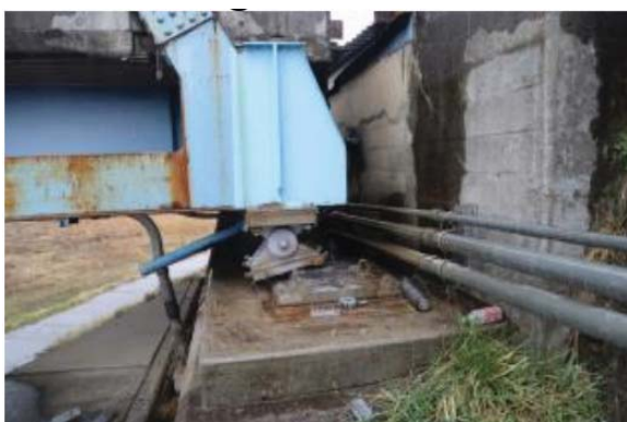
Hình 4: Hư hỏng gối cầu Date
