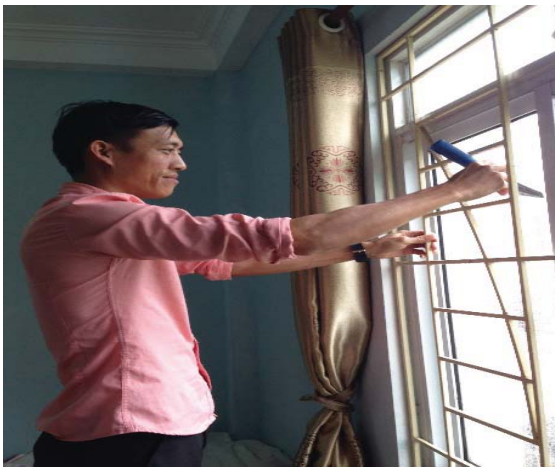
Hình 7. Thi công cải tạo cách nhiệt cửa kính trong suốt bằng phim cách nhiệt tại công trình
