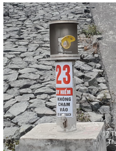
Hình 6. Móc quan trắc gắn ở các cơ hạ lưu đập
