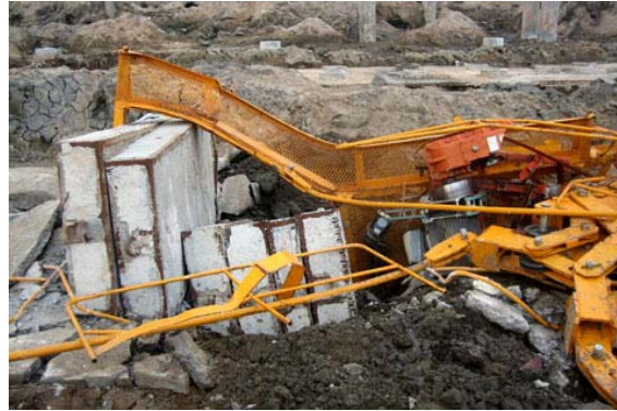
Hình 2. Sự cố sập cần trục tháp tại công trình xây dựng tại tỉnh Bình Dương
