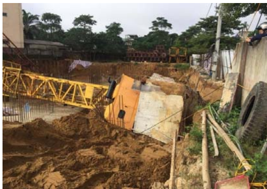
Hình 1. Hiện trường vụ sập cần trục tháp tại Tp. Vinh
