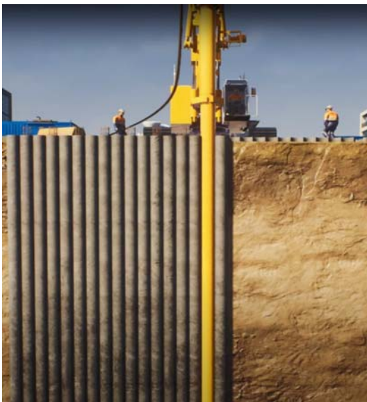
Hình 8. Hình ảnh minh họa cho công tác khoan tạo lỗ cọc cắt giữa (cọc có cốt thép)
