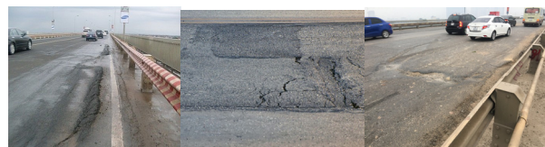
Hình 1. Hiện trạng mặt cầu trước khi sửa chữa
