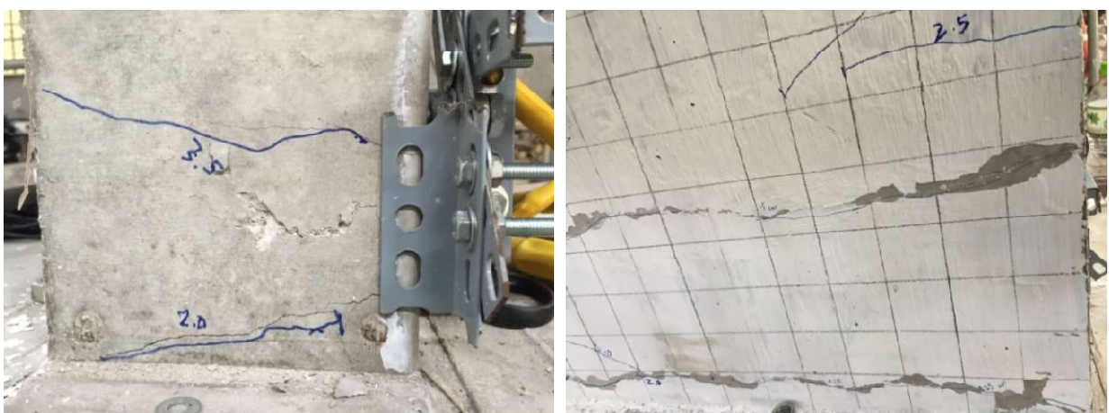
Bê tông bị ép vỡ
