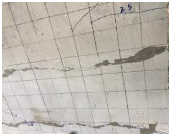
Vết nứt ngang trên toàn bộ tiết diện
