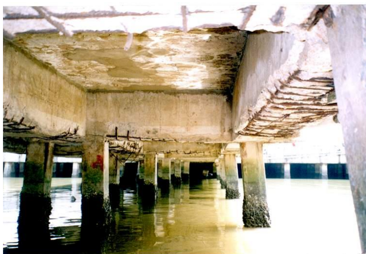
Hình 1. Công trình bị hư hỏng và xuống cấp do sự ăn mòn cốt thép [1]
