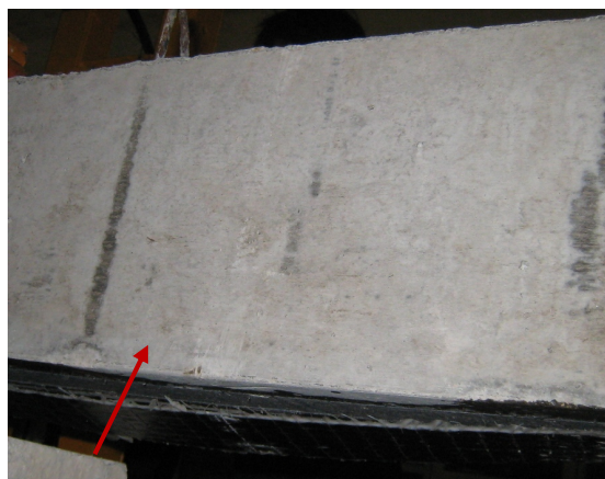
Tấm CFRP bị bong khỏi bề mặt bê tông b- Dầm gia cường
