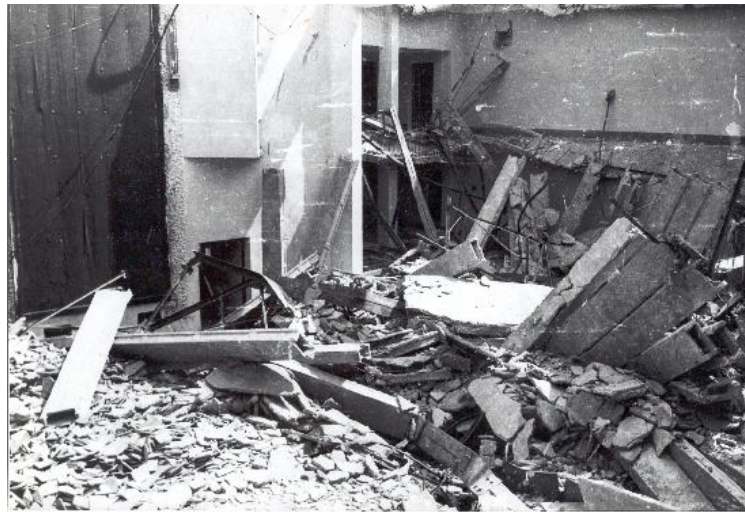
Ảnh 4. Vì kèo sập đổ hoàn toàn do tải trọng mái vượt khả năng chịu lực của vì kèo
