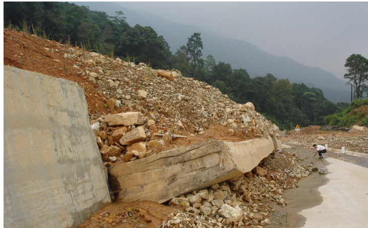
Ảnh 6. Sạt taluy đường do bạt núi làm đường
