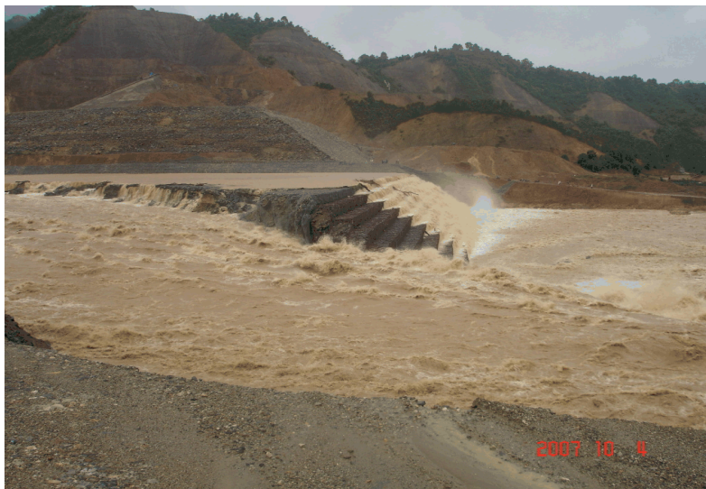
Ảnh 3. Toàn cảnh đập Cửa Đạt cao trình 50 đang thi công bị phá hoại do lũ ngày 4/11/2007
