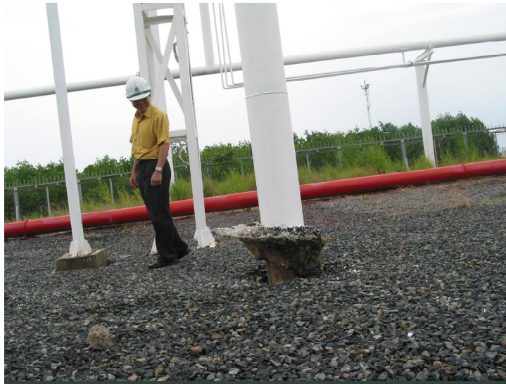
Ảnh 5. Nền bị lún do tải trọng của lớp đất đắp, tôn nền
