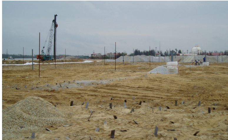
Hình 1. Các mốc đo lún trên mặt bằng dự án xây dựng kho cảng container Chùa Vẽ, Hải Phòng
