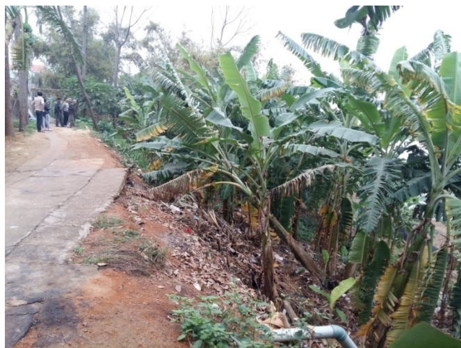
Hình 4. Sạt lở làm hỏng đường giao thông tại xã Chu Minh
