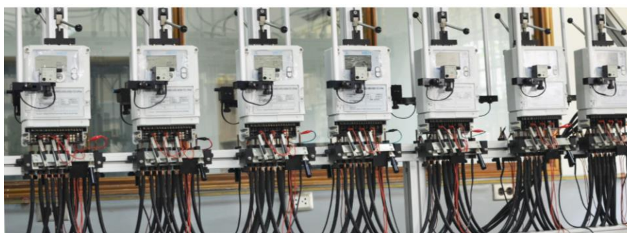
Hình 4. Kiểm định công tơ điện tại phòng Đo lường Điện của QUATEST 3
