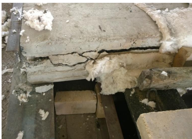
Hình 11. Vết nứt ở góc đầu tấm gây hỏng về tính toàn vẹn
