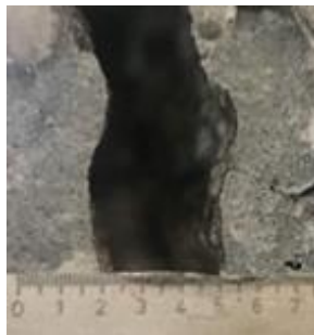
Hình 5.5 Vết nứt của tấm P18-1 tại P_y = 3,0 kN
