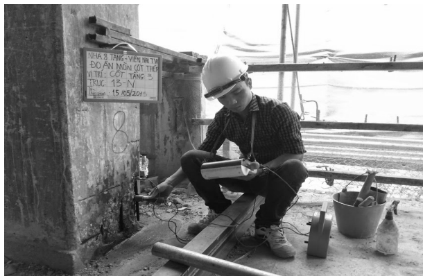
Hình 3. Kiểm tra mức độ ăn mòn cốt thép trong bê tông bằng phương pháp đo điện thế, thiết bị CANIN
