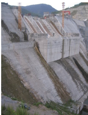
Hình 2. Thấm qua khe biến dạng đập thủy điện Bản Vẽ
