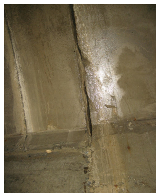
Hình 3. Thấm qua khe biến dạng đập thủy điện Bản Chát
