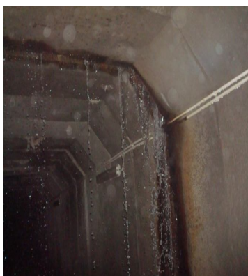
Hình 1. Thấm qua khe biến dạng đập thủy điện Sông Tranh 2
