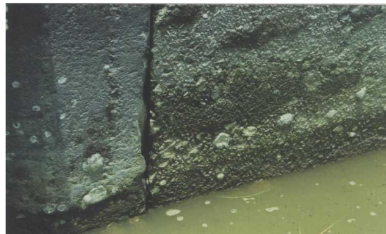
Hình 2. Dạng bê tông bị ăn mòn ở vùng “mặn”
